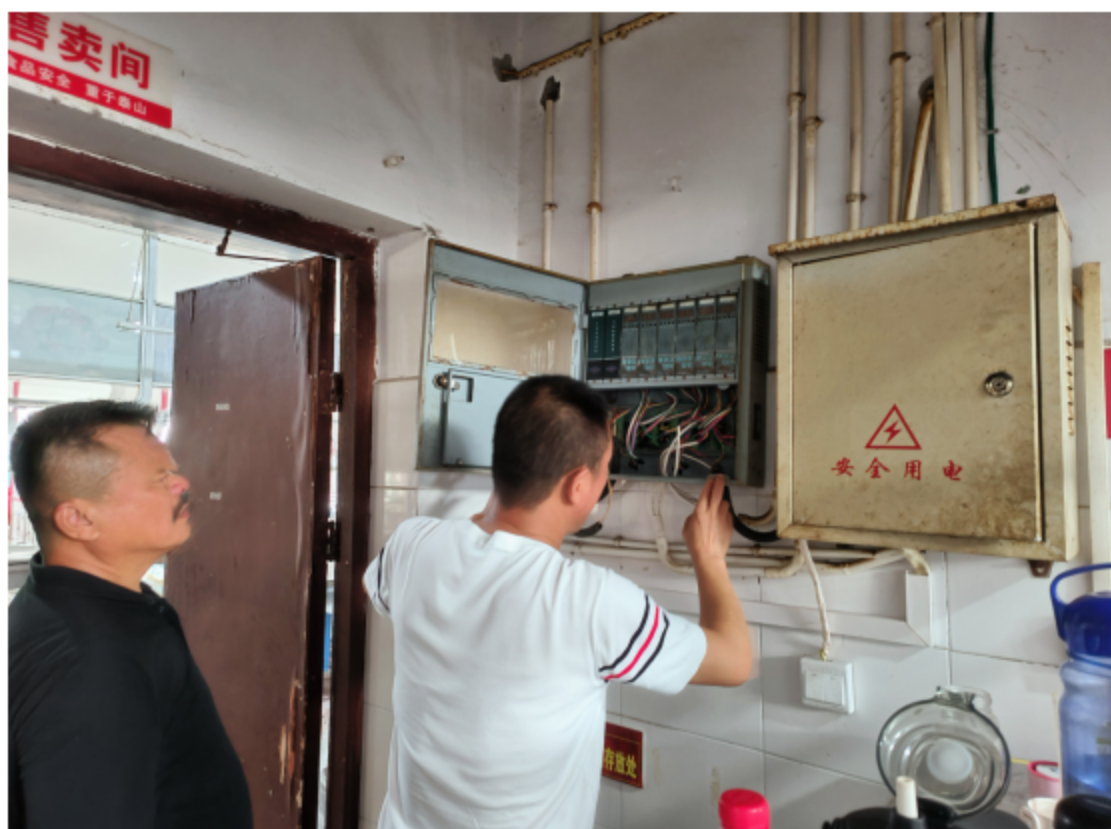
学校电路进行检查
